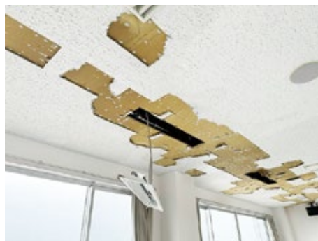
漏水で天井が剥がれた講義室
